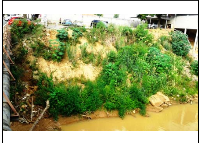
Detalhe do solapamento ocorrido na margem direita do Rio Santa Maria do Rio Doce.
