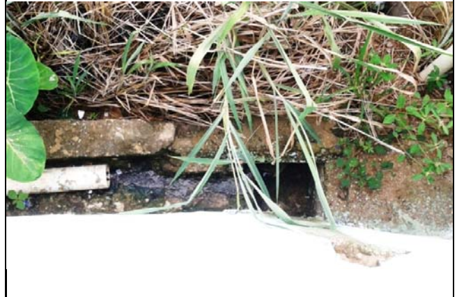
Lançamento de água servida no topo do talude natural.
