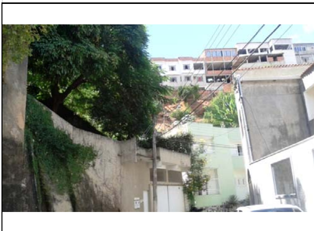
Vista de talude de corte situado a jusante das moradias.
