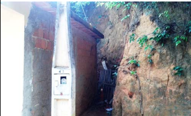
Talude de corte com presença de cicatrizes de escorregamento planar. Nas proximidades da árvore houve o desmoronamento de uma moradia devido ao escorregamento planar ocorrido no local.
