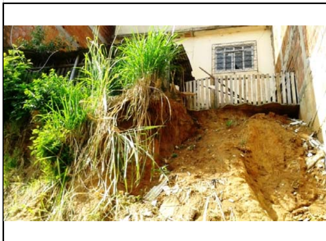
Cicatriz de escorregamento planar em talude de corte de aproximadamente 4,0 metros de altura e 70° de inclinação. Nota-se distância de menos de 1,0 metros da moradia a montante do talude. Presença de depósito de escorregamento pretérito.
