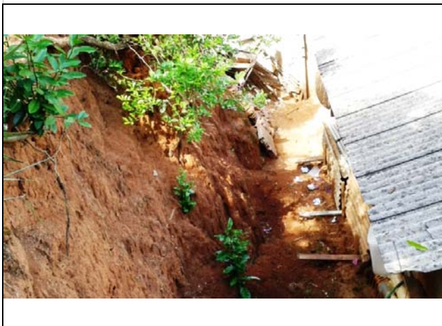
Corte de aproximadamente 4,0 metros de altura em talude situado atrás de moradia. Observa-se distância de 1,5 metro até a base do talude. Presença de cicatriz de escorregamento planar e forte processo erosivo.
