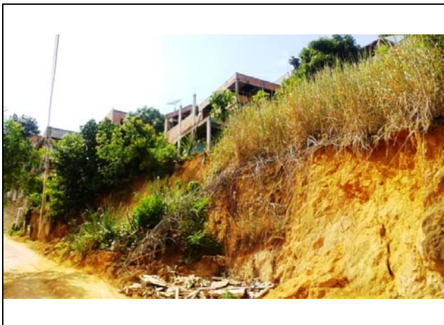
Talude de corte na beira da rua com altura de aproximadamente 3,0 metros e 80 graus de inclinação e com presença de cicatrizes de escorregamentos planares e depósitos de escorregamentos. Notam-se algumas trinças no terreno.
