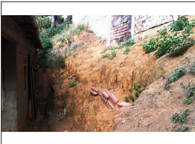
Cicatriz de escorregamento planar em talude de corte de 2,0 metros de altura e 70° de inclinação, composto por solo residual. A moradia localizada a montante do talude de corte dista 0,5 metro do topo do talude e a moradia localizada a jusante, dista 1,0 metro da base do talude de corte.
