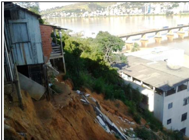
Casas danificadas, no topo de talude de corte de mais de 12 metros de altura e 60° de inclinação devido a movimentação de massa do tipo planar. É possível observar a cicatriz deixada pela movimentação de massa e sulcos no talude. Devido ao deslizamento as casas estão extremamente próximas do topo do talude e foram interditadas. Na foto ainda percebe-se a presença de alguns pedaços das moradias
