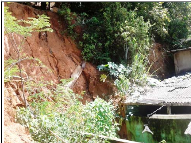
Talude de 3,0 metros de altura e 90° de inclinação apresentando cicatriz de escorregamento do tipo planar, e está sofrendo com processos erosivos bastante evidentes. Há moradias distantes 2,0 metros do topo do talude.
