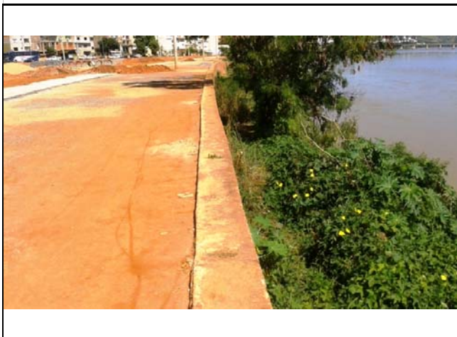
Muro existente na margem direita do Rio Doce.
