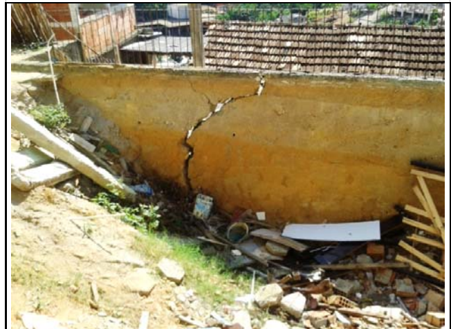
Trinca em muro no topo de talude de 4 metros de altura e 80° de inclinação, resultante de movimentação de massa do tipo planar. A casa foi demolida restando apenas o muro trincado, é possível ver na foto escombros ainda.
