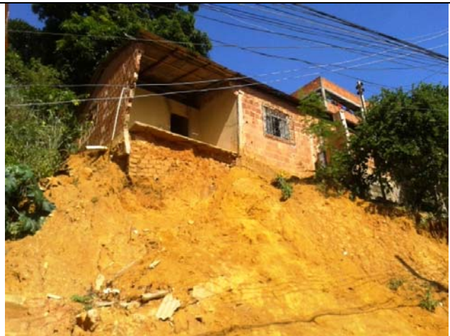
Casa no topo de talude de 4 metros de altura e 80° de inclinação que foi bastante danificada por movimentação de massa do tipo planar.
