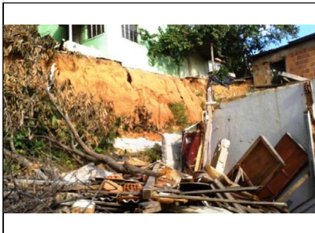
Cicatriz de escorregamento planar em talude de corte com 4,0 metros de altura e 70° de inclinação. A moradia a jusante foi atingida pelo depósito de escorregamento pretérito, ficando completamente danificada. A moradia a montante está muito próxima do topo do talude (1,0 metro) e também possui evidências, como trincas no terreno. Há, ainda, presença de sulcos no talude de corte.
