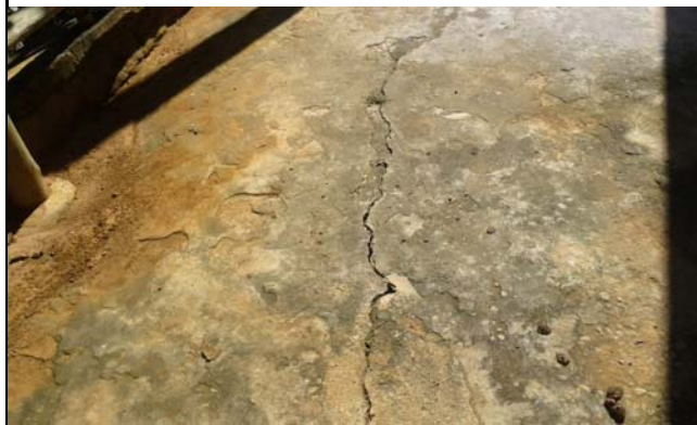
Trinca em terreno observada no topo de talude de corte com altura de aproximadamente 10,0 metros e 70° de inclinação, onde encontram-se moradias em sua base.
