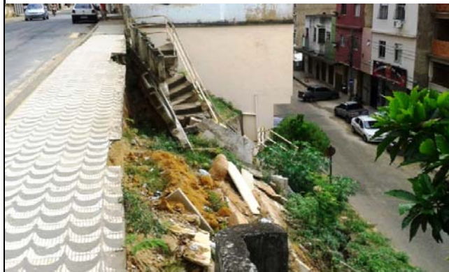
Escadaria de acesso para a rua situada a jusante que foi danificada por escorregamento planar ocorrido em talude de corte com altura de 5,0 metros e 70° de inclinação. Nota-se, também, que parte do muro de contenção na beira da calçada a montante também ficou danificado.
