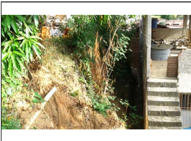
Talude de corte que se encontra muito próximo da moradia situada a jusante (menos de 1,0 metro). Observou-se erosão laminar e erosão linear do tipo sulco.
