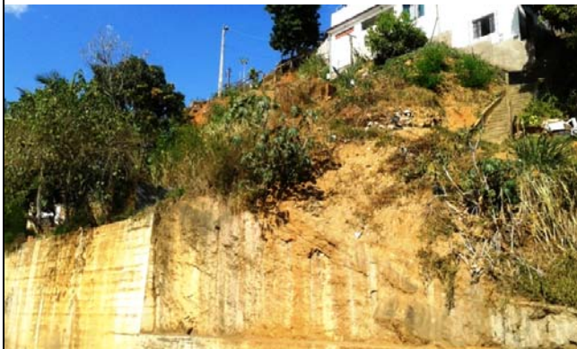
Talude de corte com altura de aproximadamente 6,0 metros e 60° de inclinação. Na base há presença de rocha sã. Nota-se cicatriz de escorregamento planar juntamente com processo erosivo bastante evidente. Presença de muro de contenção na base do talude de corte, com altura de aproximadamente 1,5 metro.
