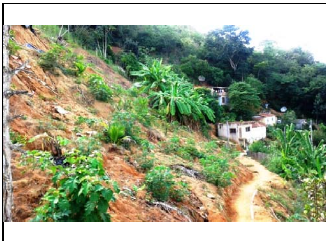
Detalhe da cicatriz de escorregamento planar em talude de corte. Nota-se danos na via de acesso.
