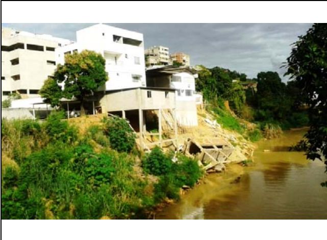
Vista do talude marginal e de parte de moradia derrubada devido a inundação ocorrida em dezembro de 2013.
