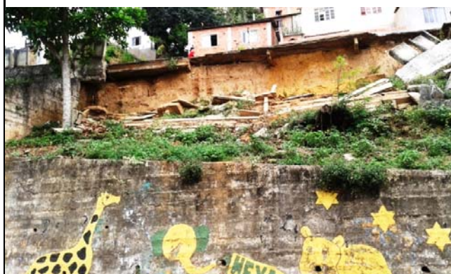
Parte da calçada na Avenida das Nações danificada pelo escorregamento planar ocorrido no local, afetando muro de contenção e escadaria de acesso.
