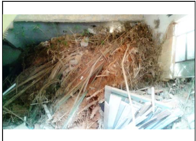
Moradia atingida na base do talude de corte com o depósito de escorregamento pretérito invadindo a parte de dentro da residência. A estrutura da moradia encontra-se danificada.
