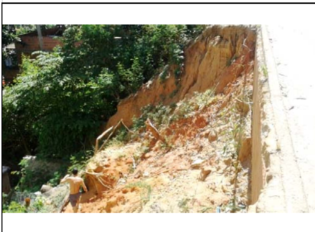
Cicatriz de escorregamento planar no topo de talude de corte à beira da Avenida das Nações, onde se observam moradias na base. Processo erosivo bastante evidente.
