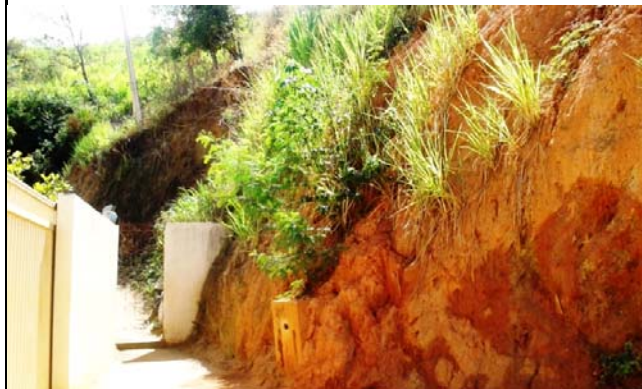
Talude de corte com aproximadamente 7,0 metros de altura e 70° de inclinação. Notam-se cicatrizes de escorregamentos planares e processo erosivo bastante evidente. Presença de moradias na base do talude com distâncias variando entre 1,5 a 3,0 metros.
