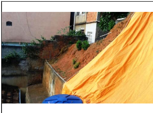
Cicatriz de escorregamento planar em talude de corte de 6,0 metros de altura e 70° de inclinação, composto por solo residual. Na base do talude há muro de contenção. A casa a jusante do talude de corte dista, aproximadamente, 1,5 metro da base do talude.
