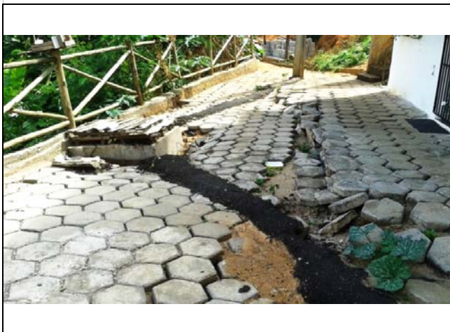
Degrau de abatimento no topo de talude de corte com aproximadamente 7,0 metros de altura e 80° de inclinação. O muro que se encontra no talude de corte está inclinado.
