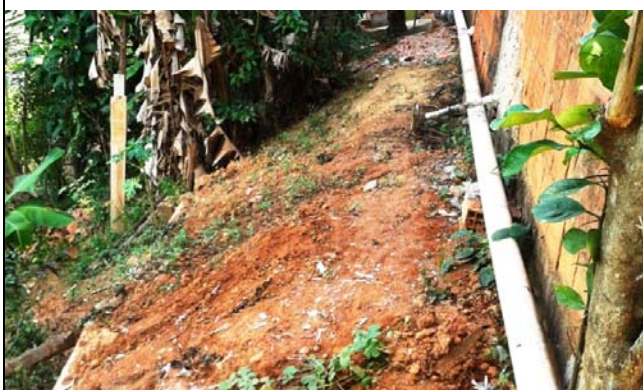
Água servida sendo lançada no topo do talude de corte. Nota-se também, presença de bananeiras.
