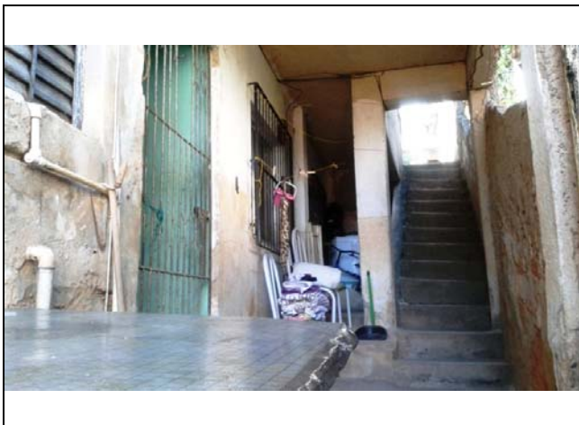
Marca d'água de altura aproximada de 1,5 metro em residência que se encontra dentro da área de inundação do Rio Doce. Essas moradias sofrem com a inundação por estarem abaixo do nível da rua.
