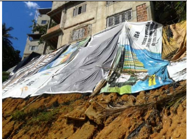
Cicatriz de movimentação de massa do tipo planar em talude de 5 metros de altura e 70° de inclinação, aproximadamente, com moradias distantes 1 metro do topo do talude. O talude apresenta muitos sulcos e um solo de coloração marrom, com granulometria silto-arenosa. Moradores utilizaram lonas e sacos plásticos para tentar impedir o avanço da erosão do talude.
