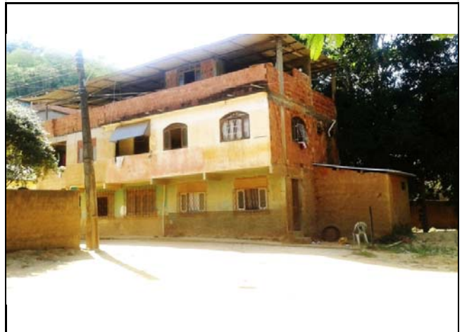
Marca d'água em moradia, com aproximadamente 6,0 metros de altura.
