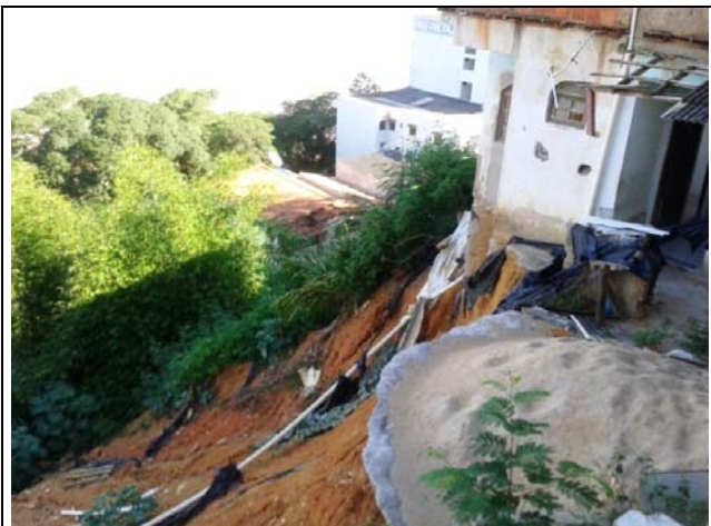
Casas danificadas, no topo de talude de corte de mais de 12 metros de altura e 60° de inclinação devido a movimentação de massa do tipo planar. É possível observar a cicatriz deixada pela movimentação de massa e sulcos no talude. Devido ao deslizamento as casas estão extremamente próximas do topo do talude e foram interditadas.
