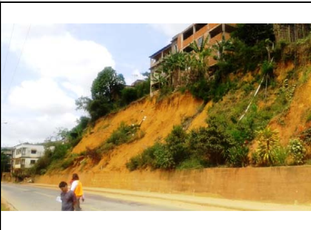
Cicatriz de escorregamento planar em talude de corte de aproximadamente 12,0 metros de altura e 70° de inclinação, o qual na última ocasião em que escorregou fez com que as moradias em seu topo ficassem muito próximas (1,0 metro) e atingiu uma moradia na base do talude (esquerda na foto).
