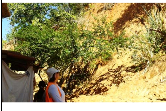
Cicatriz de escorregamento planar em talude de corte de 5,0 metros de altura e 70° de inclinação, aproximadamente. Apresenta em sua base, depósito de escorregamento e em seu topo, vegetação de gramíneas e árvore inclinada.
