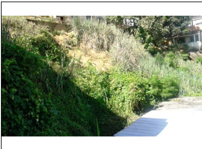
Cicatriz de escorregamento planar ocorrida em talude de corte com 10,0 metros de altura e 60° de inclinação. O depósito deste escorregamento atingiu o muro da edificação que encontra-se na base.
