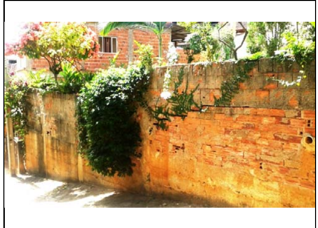
Muro de contenção trincado.
