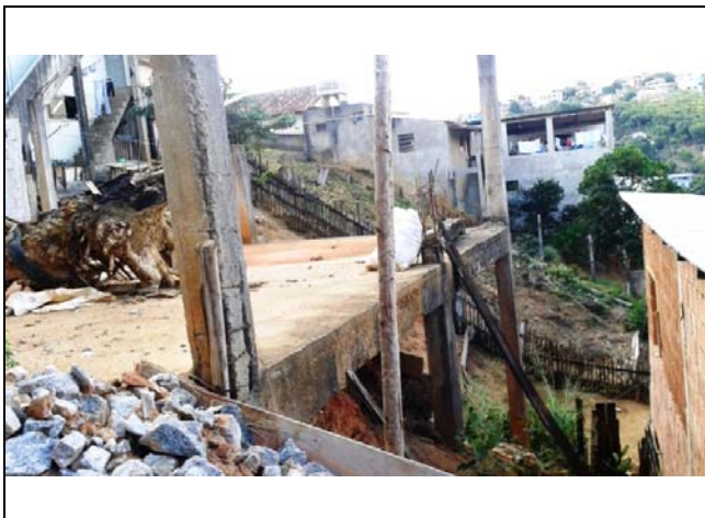
Talude de corte de 5,0 metros de altura e 60° de inclinação com processo erosivo bastante evidente e presença de gramíneas cobrindo boa parte do talude.
