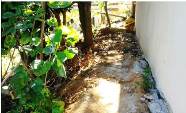
Foto mostrando erosão laminar em talude natural de cerca de 20,0 metros de altura e 60° de inclinação, composto por solo residual. Observa-se moradia localizada a montante do talude, distante 1,5 metro do topo do mesmo. Nota-se ainda a presença de árvores de médio porte localizadas no topo da encosta natural.
