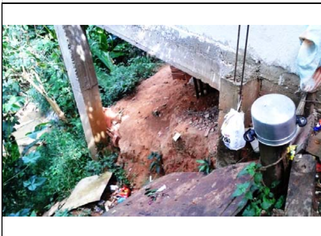
Moradia no topo do talude marginal do Córrego do Jacarandá. Este talude possui aproximadamente 8,0 metros de altura e 70° de inclinação. A moradia situa-se a aproximadamente 2,0 metros do topo do talude marginal. Presença de lixo no topo e processo erosivo aparente.
