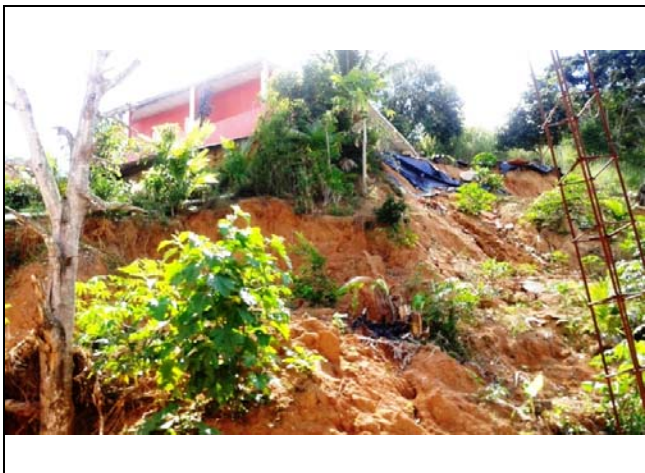
Talude de corte com aproximadamente 10,0 metros de altura e 70° de inclinação com presença de cicatriz de escorregamento planar e depósitos pretéritos. Observa-se moradia no topo deste talude situada a aproximadamente 1,5 metro do topo. Nota-se presença de erosão laminar e sulcos.
