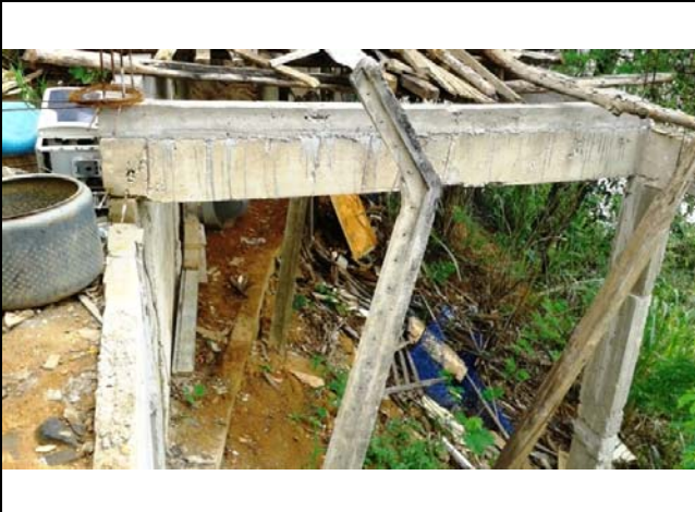
Presença de depósitos antrópicos de entulho no topo do talude natural e muro de moradia com ocorrências de trincas.
