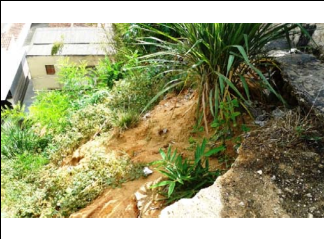
Talude de corte de aproximadamente 10,0 metros de altura e 70° de inclinação, com presença de cicatriz de escorregamento planar e forte processo erosivo.
