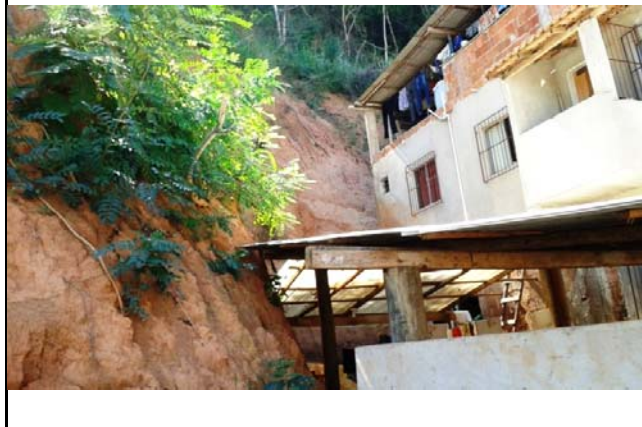
Talude de corte de 5,0 metros de altura e 70° de inclinação, situado a montante da moradia e com presença evidente de processos erosivos laminares. A vegetação, localizada no topo do talude, é composta por gramíneas e árvores de pequeno e grande porte.
