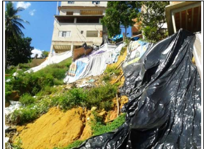
Cicatriz de movimentação de massa do tipo planar em talude de 5 metros de altura e 60° de inclinação com moradias distantes de 0 a 2 metros do topo do talude. É possível ver ainda sulco e entulhos de moradias danificadas pela movimentação de massas na base do talude. Moradores utilizaram lonas e sacos plásticos para tentar impedir o avanço da erosão do talude.
