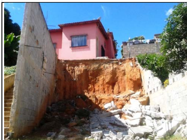
Talude de corte de 3,0 metros de altura e 90° de inclinação, aproximadamente, apresentando cicatriz de escorregamento do tipo planar e depósito pretérito e entulho na base. Está sofrendo com processos erosivos e há moradias distantes 3,0 metros do seu topo.
