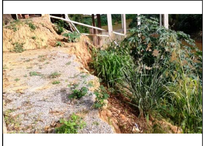
Solapamento ocorrido em talude marginal do Rio Santa Maria do Rio Doce.
