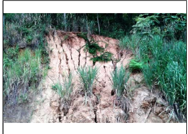
Feições erosivas lineares do tipo sulco observadas em cicatriz de escorregamento planar na base do talude, onde possuem cortes de até 5,0 metros de altura e inclinações mais acentuadas, podendo chegar a 80°.
