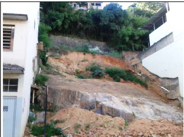
Cicatriz de movimentação de massa do tipo planar em talude de corte de , aproximadamente, 7 metros de altura e 60° de inclinação. No topo do talude há um muro de contenção de 2 metros de altura e na base é possível perceber a presença de depósito pretérito e de rocha.
