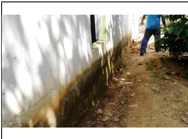
Marca d'água em parede de moradia que sofre com o processo de inundação. A moradia localiza-se a aproximadamente 6,0 metros do Córrego Jacarandá e a última inundação teve aproximadamente 0,5 de água na parte externa da residência.
