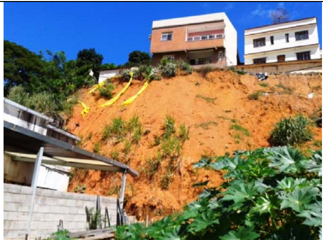
Cicatriz de movimentação de massa do tipo planar em talude de corte de, aproximadamente, 10,0 metros de altura e 70° de inclinação. Há moradias distantes 2,0 metros da base do talude e moradias distantes 4,0 metros do topo. O talude apresenta ainda depósito pretérito na base e algumas gramíneas e arbustos a meia encosta.
