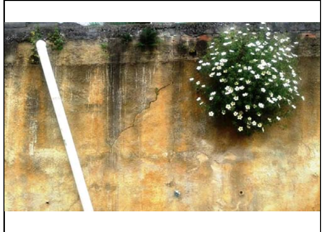
Muro de contenção em talude de corte de aproximadamente 2,5 metros apresentando trincas e embarrigamento.
