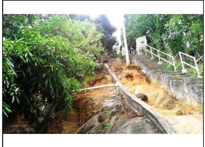
Blocos de rochas encontrados em taludes de corte.
