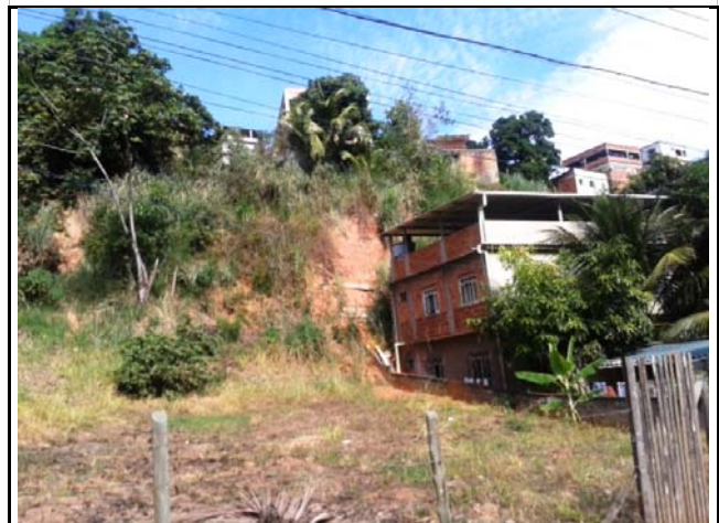
Cicatriz de escorregamento do tipo planar em talude de corte composto por solo residual. O talude de corte tem cerca de 12,0 metros de altura e 80° de inclinação. Há moradias localizadas tanto no topo quanto na base do talude. Há presença de gramíneas, vegetação arbustiva e árvores de médio porte além de solo exposto onde ocorreu o escorregamento.
