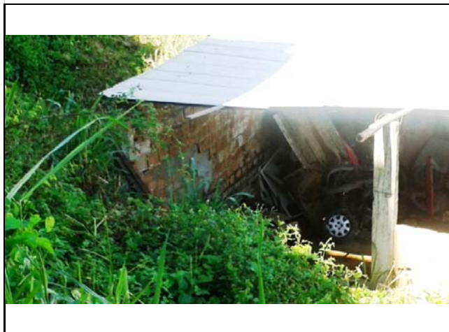
Muro trincado e embarrigado atingido pelo depósito de escorregamento planar.
