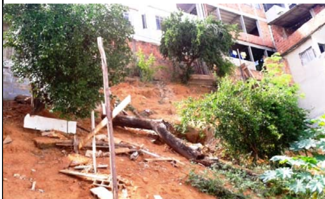
Talude de corte de altura aproximada de 6,0 metros e 60° de inclinação, com presença de árvores inclinadas e processo erosivo bastante aparente. Notam-se moradias no topo deste talude.
