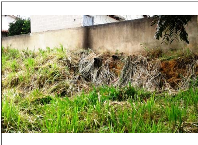
Lançamento de água superficial observado em topo de talude natural.
