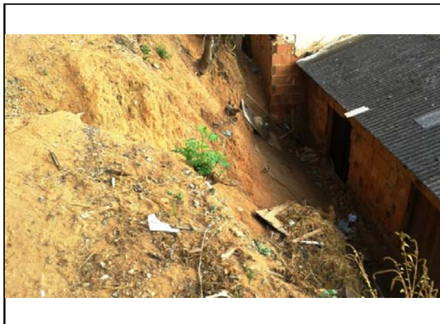
Talude de corte com aproximadamente 3,0 metros de altura e 60° de inclinação. Notam-se moradias muito próximas da base do talude, tendo de 0,0 a 0,5 metro de distância. Presença de cicatriz de escorregamento planar.
