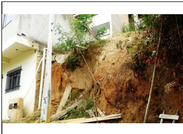
Cicatriz de escorregamento planar em talude de corte de aproximadamente 4,0 metros de altura e 70° de inclinação. No topo do talude existe moradia com aproximadamente 1,5 metro de distância.
