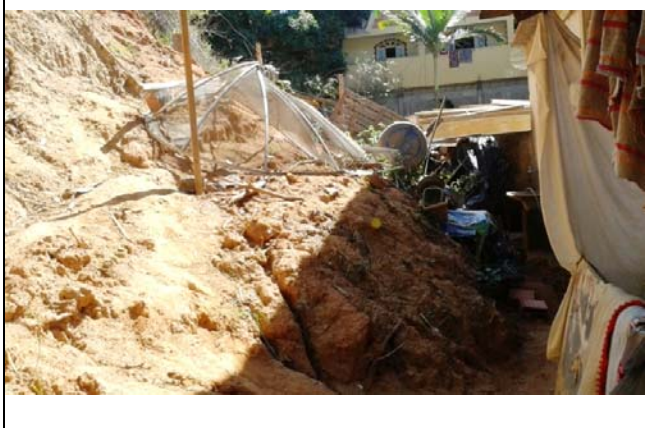
Depósito pretérito de escorregamento planar na base de talude de corte de 5,0 metros de altura e 70° de inclinação, aproximadamente. O depósito atingiu a moradia localizada a jusante do talude de corte, que dista 3,0 metros da base deste.
