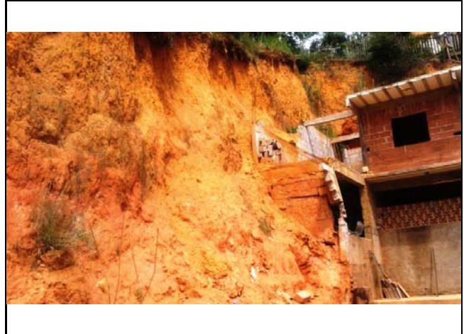
Talude de corte de 7,0 metros de altura e 70° de inclinação onde ocorreu escorregamento planar, danificando assim, o muro de contenção que vinha sendo construído.
