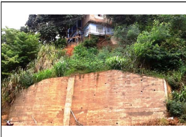
Muro de contenção presente na base do talude de corte com altura de aproximadamente 8,0 metros e 60° de inclinação. Este muro é insuficiente, visto que pode-se observar no topo deste talude trincas no terreno, assim como outro muro de contenção embarrigado.
