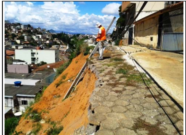
Rua danificada devido a movimentação de massa do tipo planar, causada pelas chuvas ocorridas no mês de dezembro/2013. Na foto é possível ver a cicatriz no talude com mais de 10,0 metros de altura e 70° de inclinação, postes inclinados e casas distantes 2,0 metros da base do talude.
