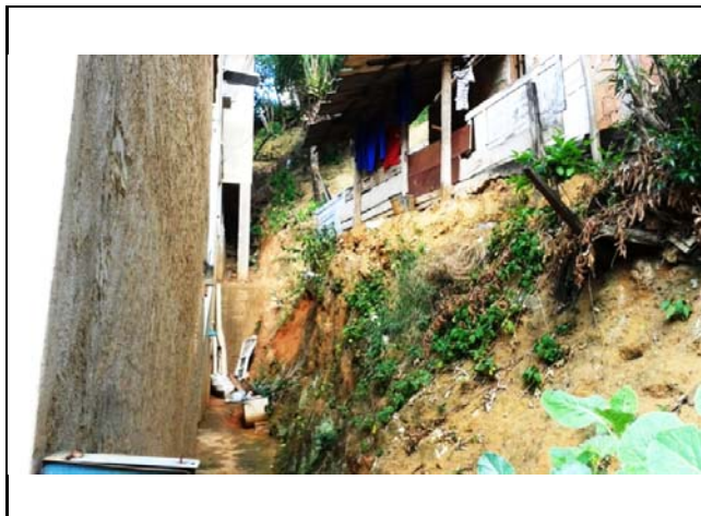
Cicatriz de escorregamento planar em talude de corte de 2,0 metros de altura e 70° de inclinação, composto por solo residual. As moradias localizadas tanto a montante quanto a jusante do talude de corte, distam 1,0 metro do topo e base do talude, respectivamente.
