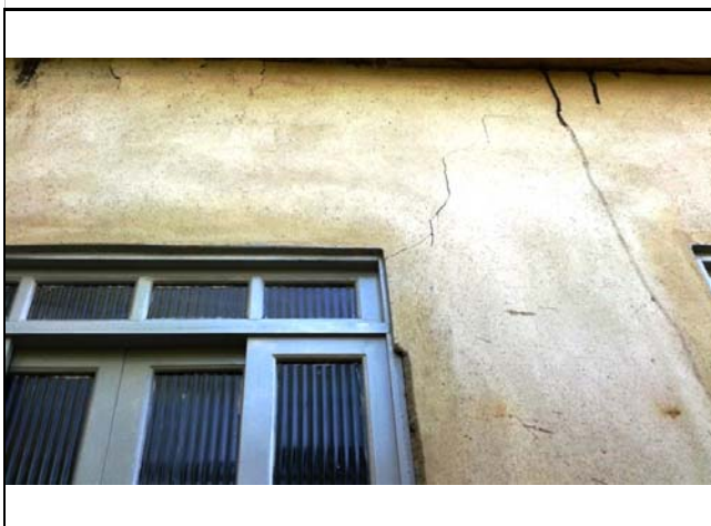
Foto mostrando trinca em moradia localizada a montante do talude de corte e topo de encosta natural, distante 2,0 metros do topo do talude de corte. O talude de corte sofreu abatimento, o que causou as trincas nesta moradia.
