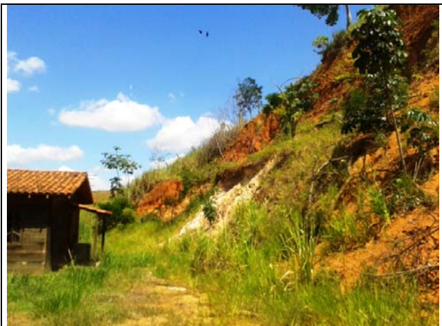
Talude natural de 10,0 metros de altura e 70° de inclinação com cicatriz de movimentação de massa do tipo planar e depósito pretérito na base. Apresenta moradia distante 3,0 metros da base do talude, gramíneas e árvores de pequeno porte em meia encosta.
