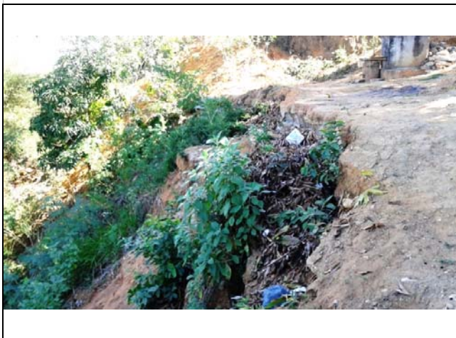
Foto mostrando degrau de abatimento em encosta natural, composta por solo residual. A encosta possui 20,0 metros de altura e 60° de inclinação.
