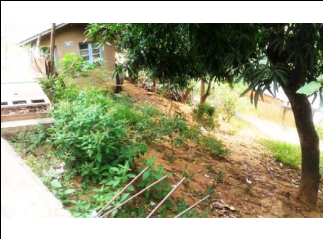
Talude de corte com aproximadamente 4 metros de altura e 50° de inclinação. Apresentando processo erosivo bastante evidente e com presença de moradias no topo.
