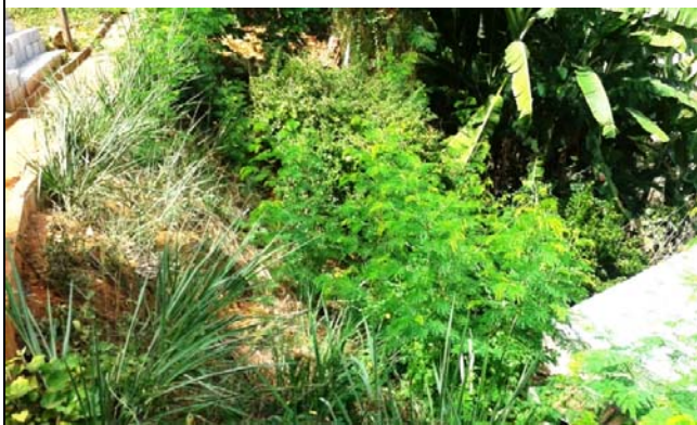
Cicatriz de escorregamento planar em talude de corte de aproximadamente 7,0 metros de altura e 70° de inclinação, situada a montante das moradias.
