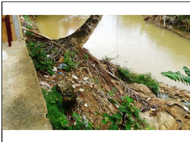
Talude marginal da margem direita do rio Santa Maria do Rio Doce, com, aproximadamente, 3,0 metros de altura e 70° de inclinação, composto por solo residual, solo aluvionar e rocha sã. Há moradia localizada a montante do talude distante 1,0 metro do topo deste. O talude sofreu solapamento com as chuvas de dezembro de 2013. Há despejo de água servida no talude.
