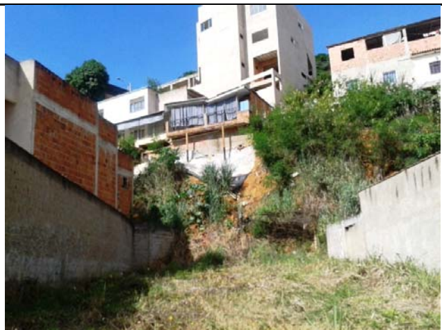
Cicatriz de escorregamento do tipo planar em talude de corte composto por solo residual. O talude de corte tem cerca de 6,0 metros de altura e 80° de inclinação. Há moradias localizadas tanto no topo quanto na base do talude. A vegetação é composta por gramíneas, arbustos e árvores de médio porte.
