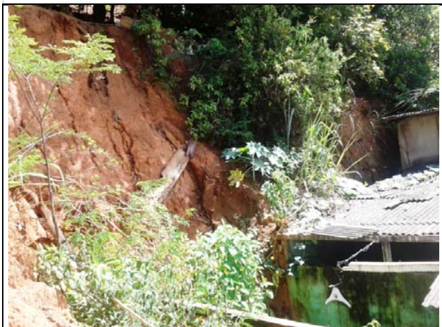
Talude de corte de 6,0 metros de altura e 70° de inclinação, aproximadamente, apresentando cicatriz de escorregamento do tipo planar, sulcos e depósito pretérito. As moradias estão distantes 2,0 metros, em média, da base do talude.
