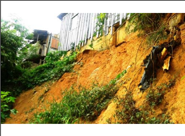
Cicatriz de escorregamento planar em talude de corte de aproximadamente 5,0 metros de altura e 70° de inclinação. Nota-se moradia bastante próxima ao topo do talude, com menos de 0,5 metro de distância.
