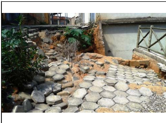
Cicatriz de escorregamento planar em talude de corte de altura 7,0 metros e 80° de inclinação. Houve danos na rua e em sistemas de drenagens encontrados na área.
