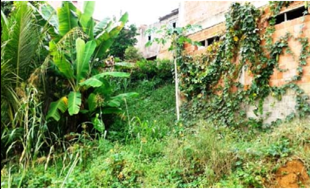
Talude natural de aproximadamente 15,0 metros de altura e 60° de inclinação, com presença de moradias em seu topo.
