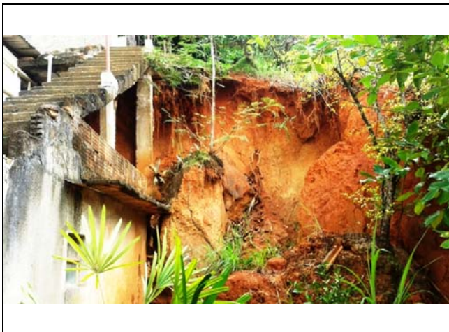
Cicatriz de escorregamento planar em talude de corte situado a montante de moradia e com altura de aproximadamente 5,0 metros e inclinação de 80°.
