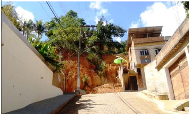
Talude de corte com presença de cicatrizes de escorregamentos planares e depósitos de escorregamentos pretéritos. Possui altura de aproximadamente 7,0 metros e 80° de inclinação. Presença de moradia na base do talude distante 0 metro e no topo 2,0 metros.
