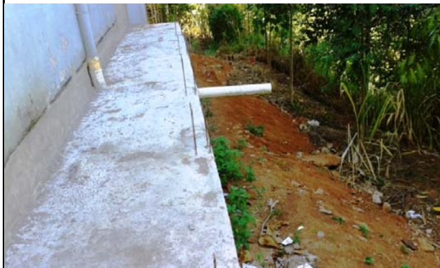
Foto mostrando lançamento de água servida em topo de talude natural, composto por solo residual. O talude possui cerca de 20,0 metros de altura e 50° de inclinação. O lançamento de água servida está contribuindo para a erosão linear e laminar do talude.
