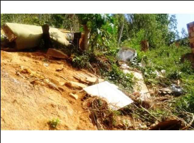
Presença de depósitos antrópicos de lixo e entulho no topo de talude de corte encontrado na área.
