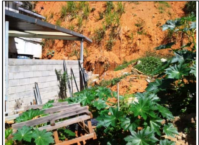
Detalhe da base de talude de 10,0 metros de altura e 70° de inclinação, com cicatriz de movimentação de massa do tipo planar, mostrando o depósito pretérito e muro de contenção de 1,5 metros de altura.
