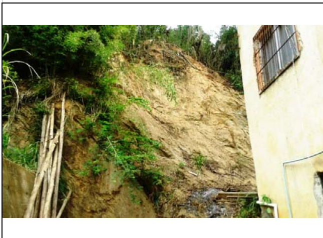
Cicatriz de escorregamento planar em talude de corte composto por paredão de rocha na base e solo residual no topo. O talude possui aproximadamente 6,0 metros de altura e 70° de inclinação. Nota-se fraturamento favorável aos escorregamentos, com direção N70E/40NW.
