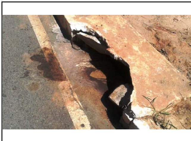
Sistema de drenagem composto por guias, sarjetas e bueiros que se encontra no local; entretanto o bueiro encontra-se danificado.
