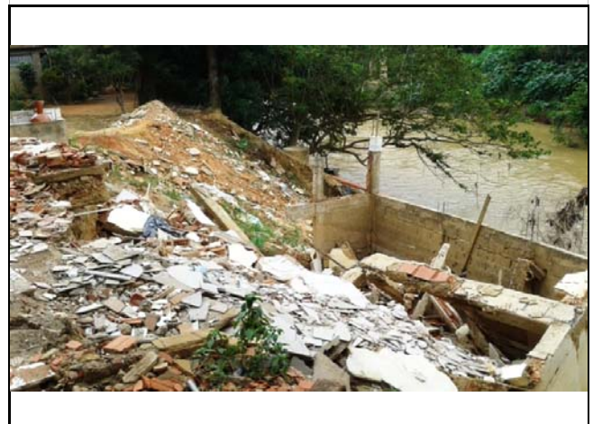
Moradia levada pela força da água em enchente que atingiu a área. Presença de solapamentos nas margens próximas desta moradia.
