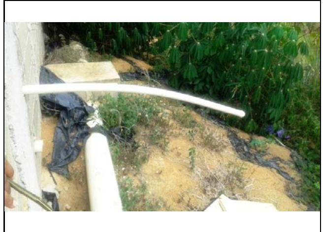
Lançamento de água servida em topo de talude de corte, onde é possível se observar cicatrizes de escorregamentos planares.
