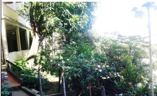
Talude de corte com presença de árvore de grande porte inclinada.
