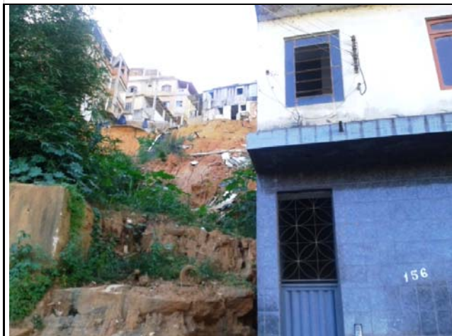
Cicatriz de movimentação de massa do tipo planar e sulcos em talude de corte de mais de 12 metros de altura e 60° de inclinação. Devido ao deslizamento as casas estão extremamente próximas do topo do talude e foram interditadas. Na base do talude há moradia distante 1 metro, no máximo, depósito pretérito e presença de rocha.
