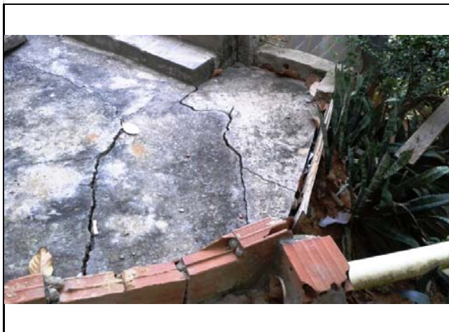
Foto mostrando trinca no chão de moradia localizada a montante do talude de corte e topo de encosta natural, distante 2,0 metros do topo do talude de corte. O talude de corte sofreu abatimento, o que causou as trincas nesta moradia. É possível observar no canto inferior direito da foto, um cano por onde é despejada água servida no topo do talude de corte.
