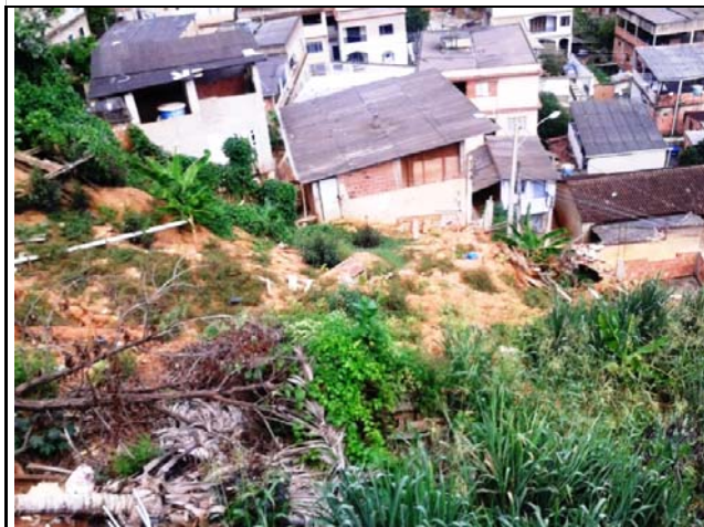
Cicatriz de escorregamento do tipo planar em talude de corte de 10,0 metros de altura e 60° de inclinação, aproximadamente. É possível observar na base do talude depósito pretérito, entulho e casas distantes 1,0 metro, em média, da base. No topo há entulhos também, além de árvores inclinadas e um cano com despejo de água servida no talude. A vegetação gramínea é encontrada tanto no topo como na base.
