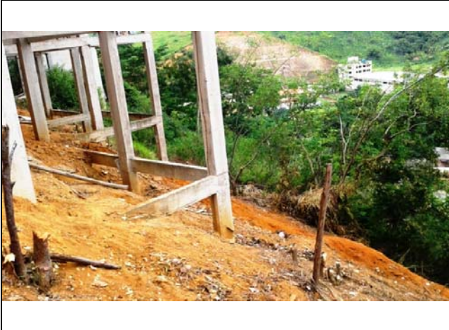
Moradias construídas em topo de talude natural de altura aproximada de 15,0 metros e ângulo de inclinação de 60°. Presença de processo erosivo bastante evidente.
