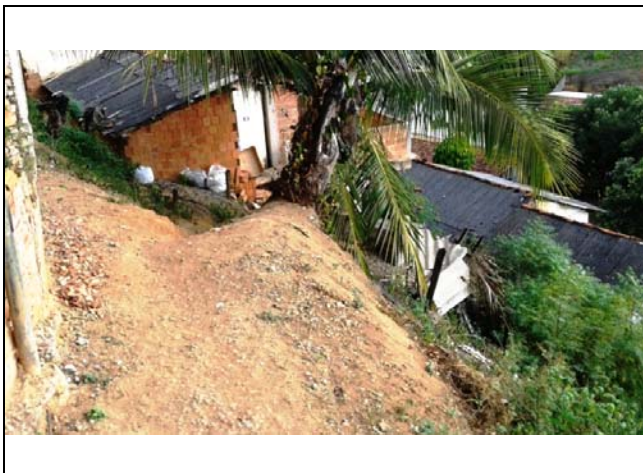
Talude de corte localizado a montante da moradia com altura de, aproximadamente, 4,0 metros e 60° de inclinação. Há presença de cicatriz de escorregamento planar e nota-se árvore inclinada.
