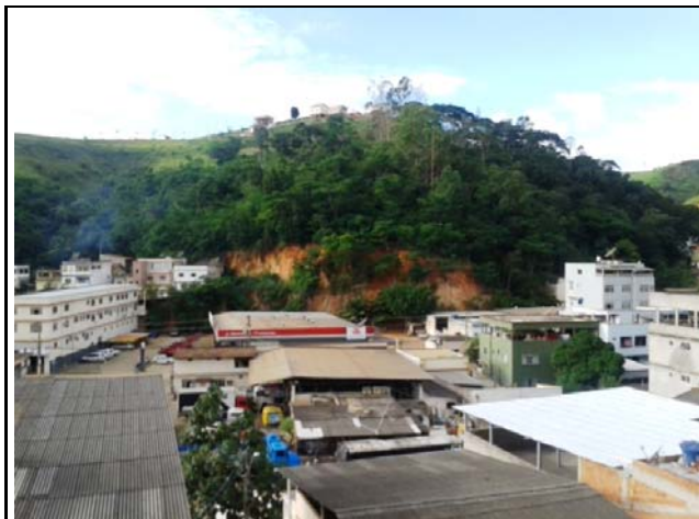
Cicatriz de escorregamento do tipo planar em talude de corte de 12,0 metros de altura e 70° de inclinação, aproximadamente. À montante deste talude, há talude natural com mais de 20,0 metros de altura e com inclinação por volta de 50°. Na base do talude de corte há moradias distantes, em média 4,0 metros e este apresenta um solo de coloração marrom de granulometria areno-siltosa. É possível perceber no talude natural a presença de vegetação gramínea e de grande porte.
