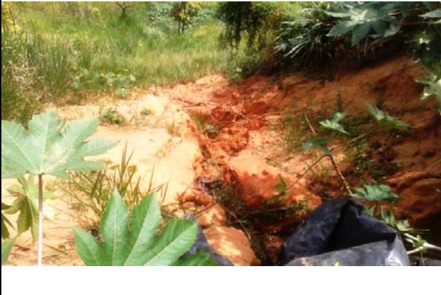
Sulco bastante grande localizado em talude de corte de aproximadamente 40,0 metros de altura e 70° de inclinação, onde se observam moradias no topo que distanciam aproximadamente 6,0 metros do talude.
