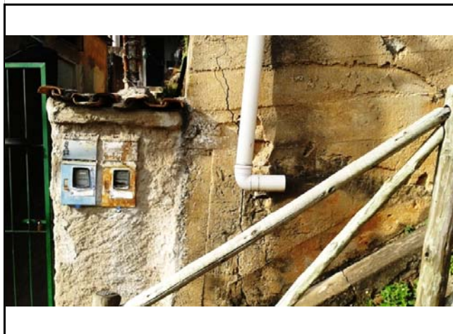
Trinca em muro de edificação.
