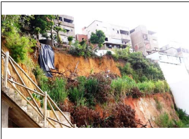
Cicatriz de escorregamento do tipo planar em talude de corte de 8,0 metros de altura, aproximadamente, e inclinação de 70°. O talude apresenta solo residual de coloração marrom, vegetação do tipo gramínea e há moradias distantes 4,0 metros do topo.
