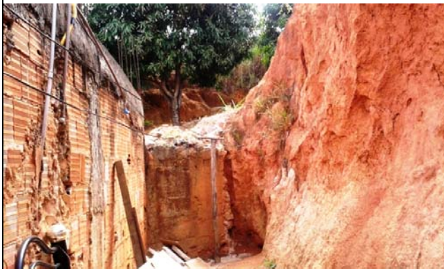
Talude de corte de aproximadamente 4,0 metros de altura e 70° de inclinação localizado atrás da moradia. A distância da moradia até a base do talude é de aproximadamente 1,5 metros. Presença de cicatrizes de escorregamentos planares e forte processo erosivo.
