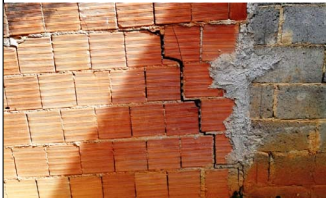
Trinca em muro de edificação localizada no topo do talude de corte de aproximadamente 8,0 metros de altura e 60° de inclinação. Nota-se lançamento de água servida no topo deste talude.
