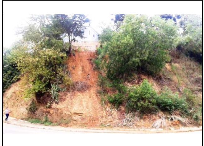
Cicatriz de escorregamento planar em talude natural de aproximadamente 12,0 metros de altura e 70° de inclinação, com moradia distante 0,5 metro do topo do talude.
