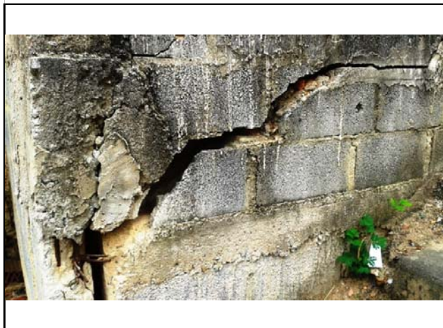
Muro de contenção trincado e embarrigado.
