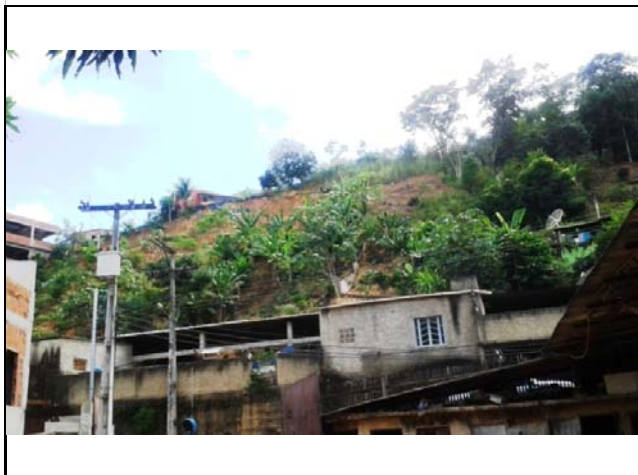
Vista geral do talude que sofreu escorregamento planar, este atingiu as moradias situadas na base do talude. Nota-se presença de bananeiras localizadas a meia encosta.
