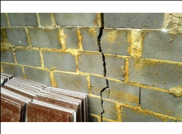
Trinca em muro de moradia. Várias moradias apresentam trincas semelhantes nos muros.
