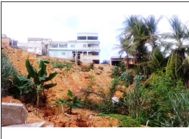
Cicatriz de escorregamento planar em talude de corte de aproximadamente 12,0 metros de altura e 60 graus de inclinação (onde havia um muro de contenção); o muro se quebrou e desceu junto com o escorregamento atingindo duas moradias na base do talude. Parte da rua encontrada no topo do talude também foi atingida. Pode-se observar ainda, degraus de abatimento, árvores inclinadas, sulcos, ravinas, poste inclinado e trinças nas moradias a jusante e montante do talude.
