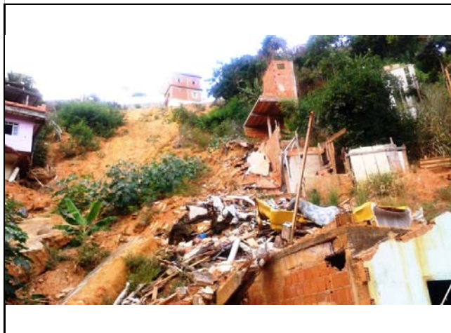
Escorregamento planar em talude de corte de altura aproximada de 10,0 metros e 70 graus de inclinação, atingindo as moradias localizadas na base e ao longo da escada que havia nas proximidades. O fato ocorreu também devido a quebra de um muro de contenção, entretanto, este muro e o talude que ele estava contendo não encontram-se dentro do limite do setor, apenas algumas moradias atingidas. Na rua a montante do talude, notam-se evidências como: trinças no terreno, trinças em muro, ravinas, sulcos e degraus de abatimento.
