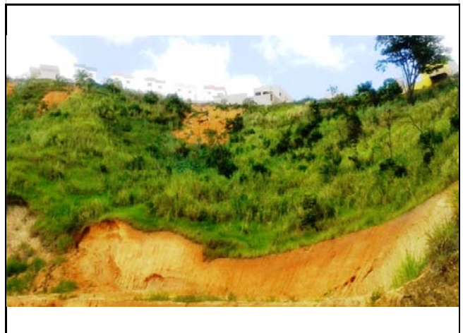
Vista geral do talude natural e de corte com presença de moradias em seu topo.
