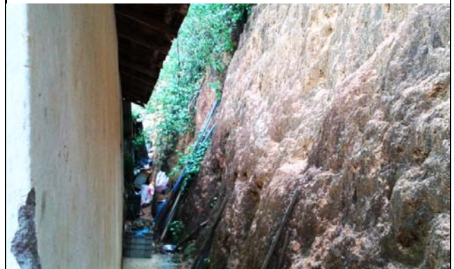
Distância de aproximadamente 1,0 metro entre moradia e base de talude de corte.
