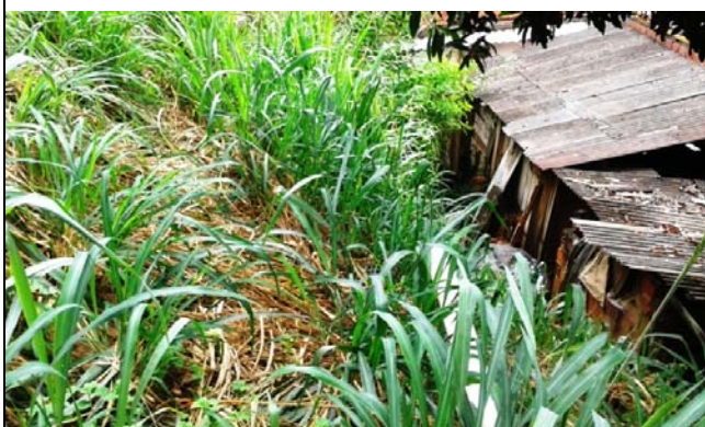
Talude de corte com 4,0 metros de altura e 60° de inclinação situado a montante da moradia. Presença de cicatriz de escorregamento planar encoberta pela vegetação.
