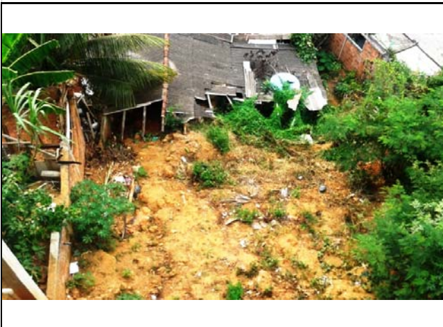
Escorregamento planar ocorrido em talude de corte de altura 5,0 metros e 60° de inclinação. Nota-se que o depósito atingiu a moradia localizada na base do talude. Já a moradia a topo, encontra-se a aproximadamente 2,0 metros de distância do talude.
