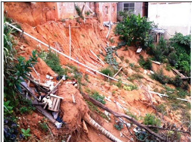
Talude de corte de 4,0 metros de altura e 70° de inclinação, apresentando cicatriz de escorregamento do tipo planar, depósito pretérito na base, sulcos próximos ao topo, árvore inclinada e alguns entulhos de moradia, no topo, que foi danificada devido ao escorregamento. Há moradias distantes, em média, 1,0 metro do topo do talude e moradias na base distantes 3,0 metros aproximadamente.
