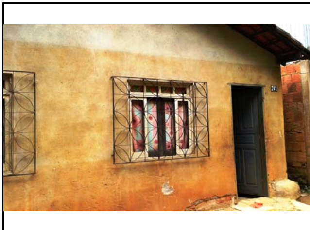
Marca de água na parede de moradia localizada na margem direita do rio Santa Maria do Rio Doce, que foi atingida pela inundação. A casa dista cerca de 10,0 metros do topo do talude marginal e o nível d'água chegou, neste local, a 2,5 metros, aproximadamente.
