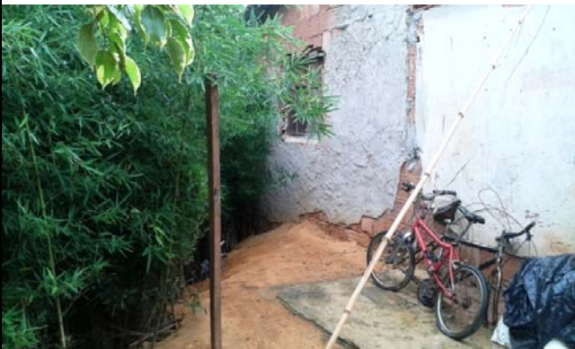
Moradia na beira do Rio Baunilha com processo de solapamento de margem.
