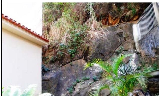
Talude de corte composto de solo residual sobre paredão de rocha bastante fraturado. O talude possui aproximadamente 8,0 metros de altura e 70° de inclinação. Nota-se que possui estruturas favoráveis ao escorregamento de atitude N40W/35NE. Presença de moradias na base do talude.
